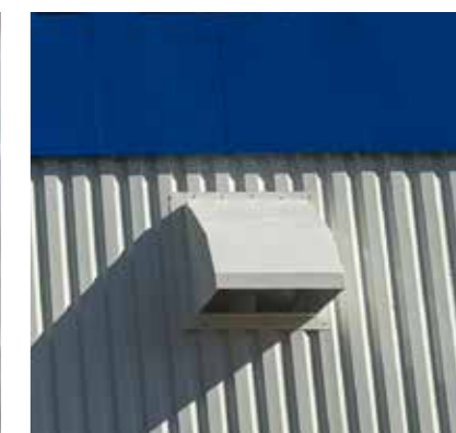
Caissons de finition
