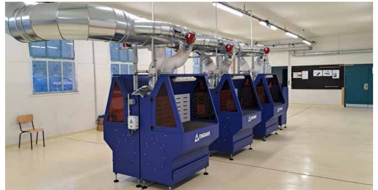
Réseau basse dépression avec tables aspirantes.
